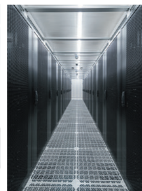
2016年12月にオープンした「EneWings広島データセンター」。通信回線からクラウド、データセンターまで一元監視・運用するサービスオペレーションセンターも併設。
